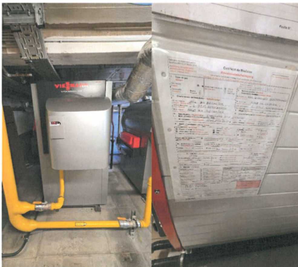
Figure 31 : Chauffage Mairie de Walferdange
